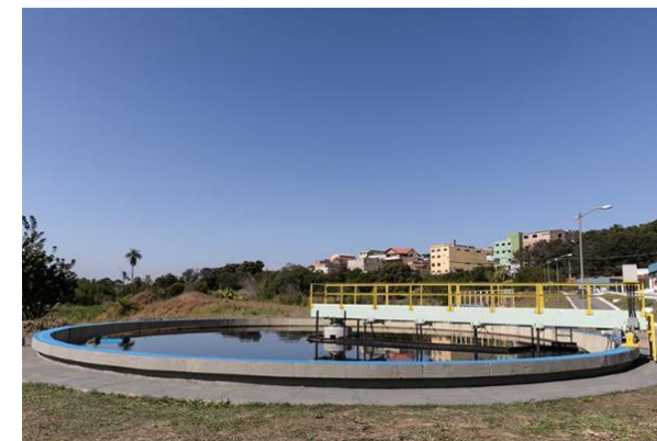
ETE – Estação de Tratamento de Esgoto Bairro Retiro
